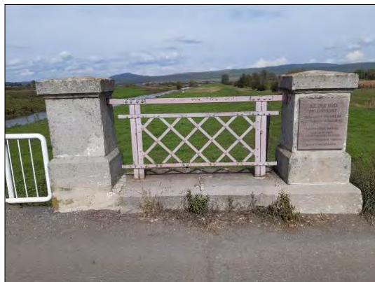
2. ábra. A régi hídfő jelenlegi állapota
