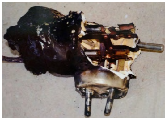
1. ábra. Kontaktkorrózió okozta károsodás villamos csatlakozónál
