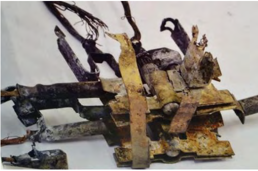
2. ábra. Kontaktkorrózió okozta károsodás villamos kötésnél
